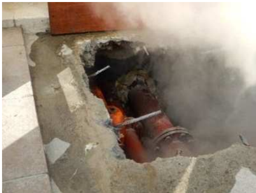
蒸気配管の老朽化
