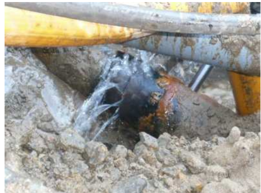
給水管の老朽化
