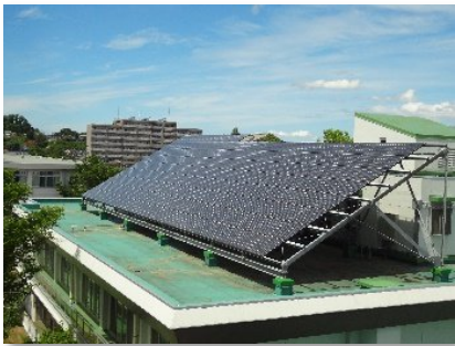
太陽光発電設備
